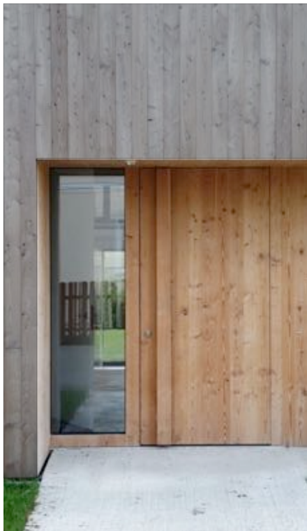
Beispiel Alterung Holzfassade bewitterte und unbewitterte Flächen
